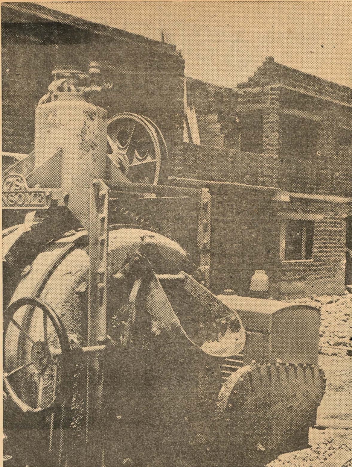
La máquina ayuda al hombre a ahorrar esfuerzo y a ganar tiempo. En la modernización de las ciudades, la máquina tiene gran importancia. Esta que se ve aquí acelera la elevación de los edificios, la pavimentación de las pistas y la renovación de las calzadas.
