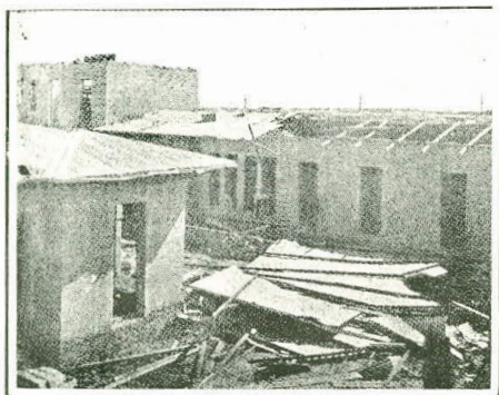
Casas para obreros, destruídas
