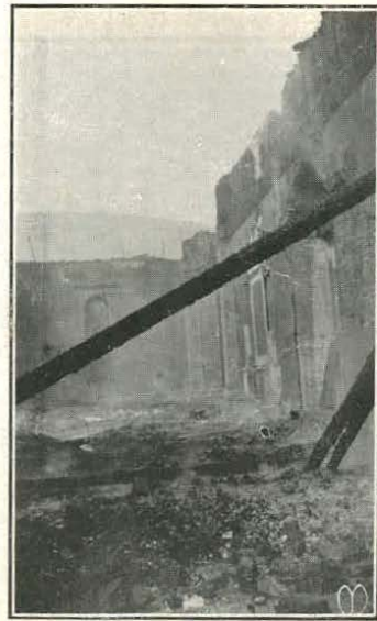
La iglesia en escombros
