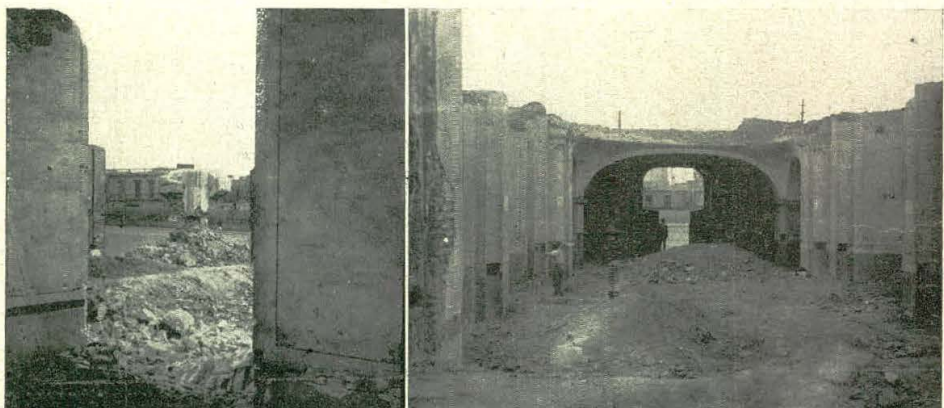
Diversos aspectos de las obras de demolición del antiguo Convento de San Juan de Dios, cuyos macisos muros han necesitado ser volados con pólvora negra.
