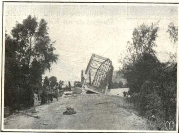
Desviación del puente por la fuerza del río
